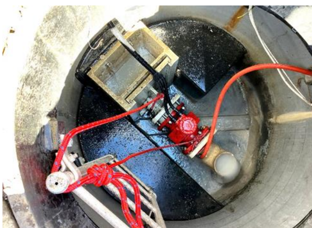
Figure 1: Nouveau puits avec mesure du débit
