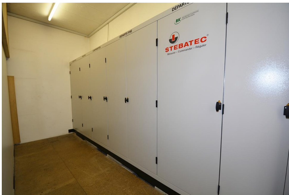
Die neuen Schaltschränke mit der wieder zeitgemässen Elektroverteilung.
