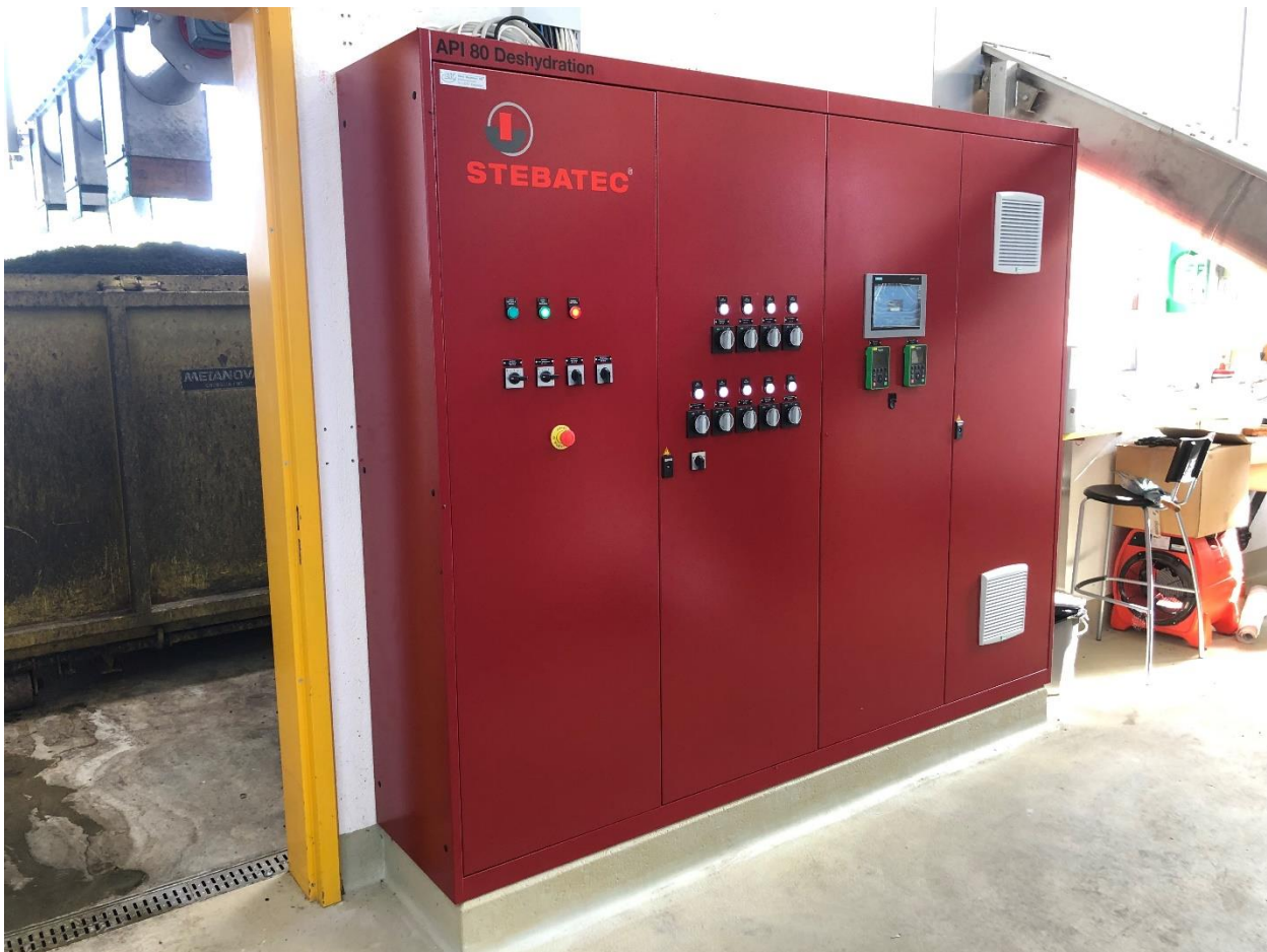
Abbildung 1: Ansicht nach dem Umbau der Schlamm Trocknungssteuerung
